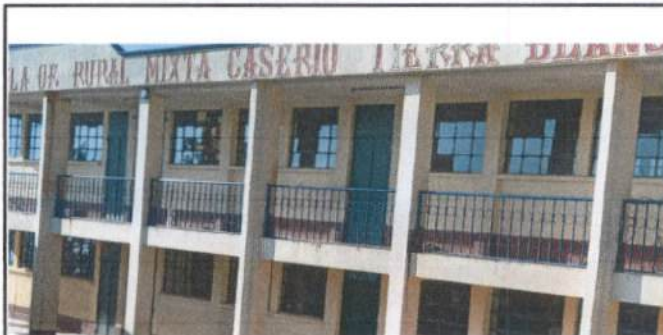
Foto 2: Es el área a trabajar con los balcones debido a que las ventanas están al descubierto y al momento de que los niños y niñas juegan algunos de los vidrios se han quebrado y eso ocasiona peligro para ellos.
