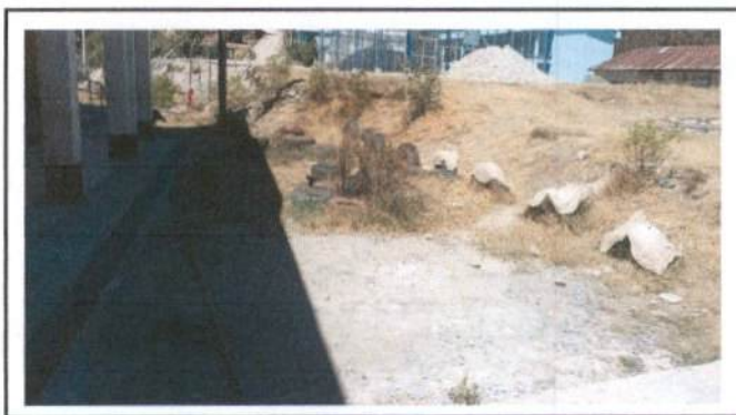
Foto 6: En esta parte se observa que se necesita de remodelar y arreglar de una mejor manera, puesto que en el tiempo de lluvia se hacen charcos y para los niños les es difícil jugar y caminar en esta área.
