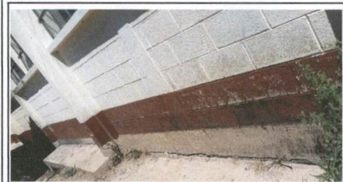
Foto 3: En esta fotografía se puede observar que por la lluvia se ha deteriorado la pintura. Por lo que se priorizará la pintura.
