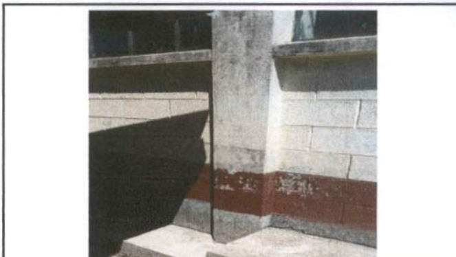
Foto 4: En esta otra parte se evidencia el deterioro de la pintura.
